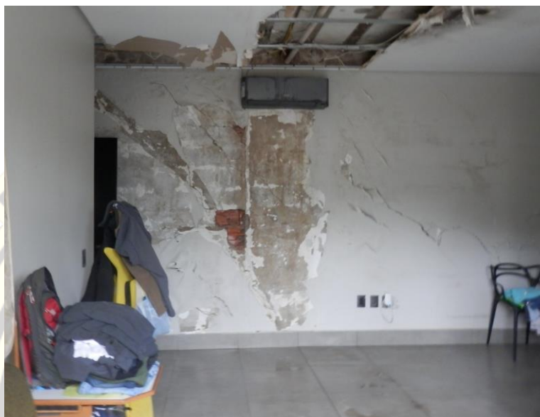
Figura 21: detalhe das severas patologias que afetam as paredes do dormitório dos fundos
