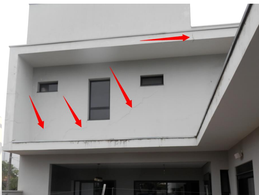
Figura 23: detalhe das fissurações significativas que se manifestam na fachada dos fundos
