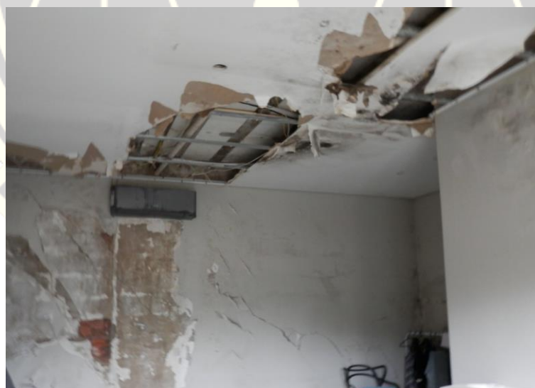
Figura 22: vista do forro do mesmo dormitório dos fundos afetado pelas infiltrações que se dão pela laje de teto (terraço) decorrente dos problemas nas fundações
