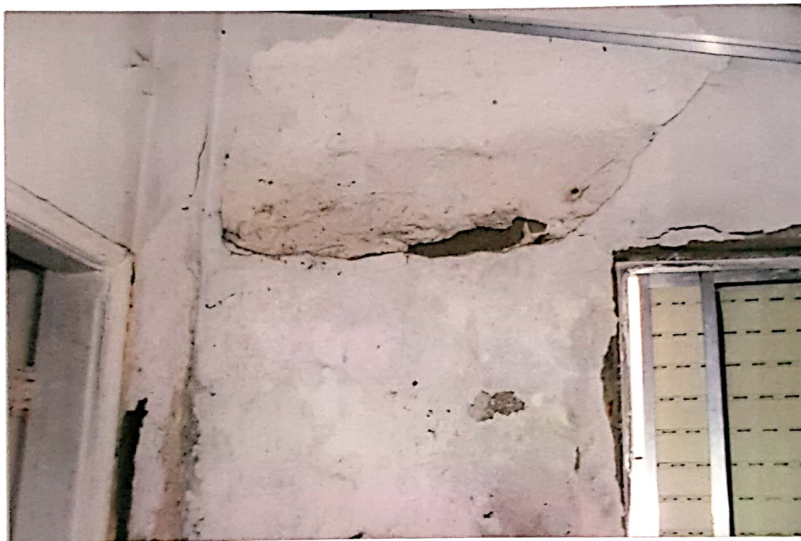
foto nº 11 outro trecho da parede da sala/dormitório indicando péssimo estado de conservação
