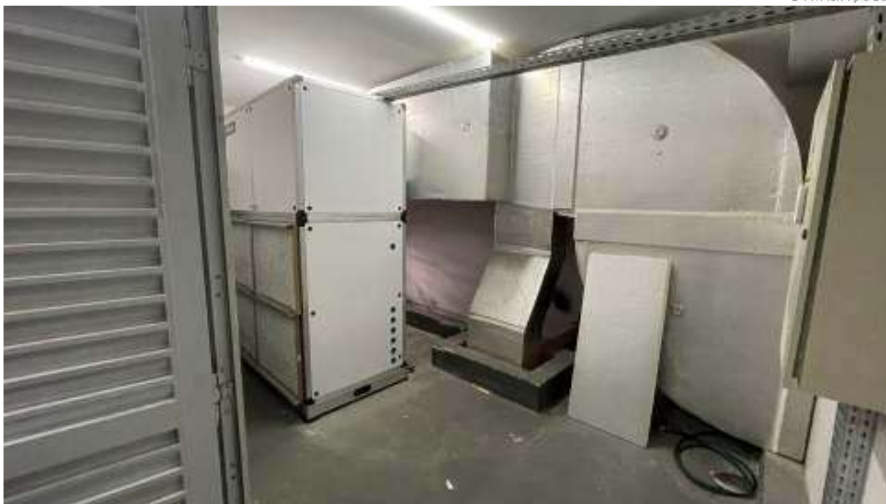
FOTO DE Nº 41. Equipamentos de ar condicionado.
