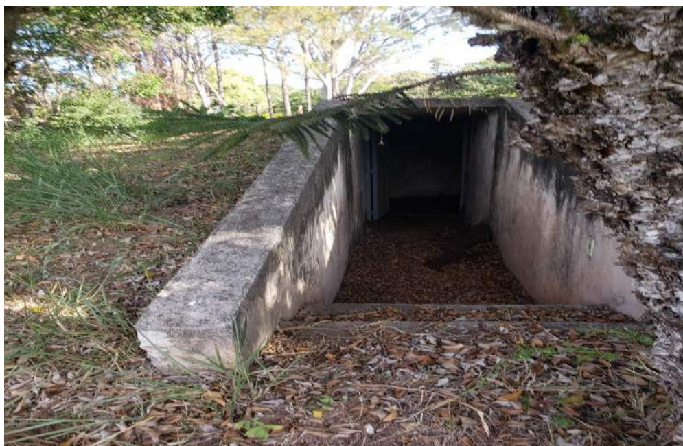
Foto entrada casa de máquinas – manutenção da piscina – desativada
