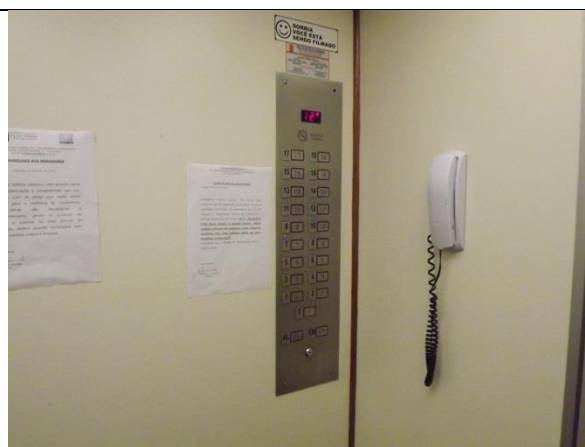
Figura 4 – Elevador do imóvel
